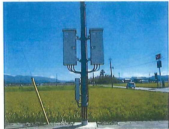
左: No.1流量変換器盤(玉城第1) 右: No.2流量変換器盤(宮川幹線MM11)
